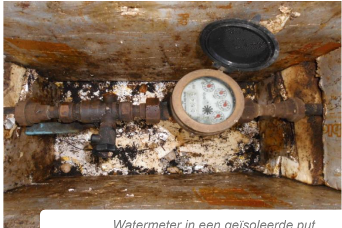
Watermeter in een geïsoleerde put.
