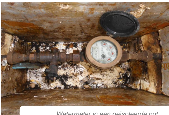
Watermeter in een geïsoleerde put.
