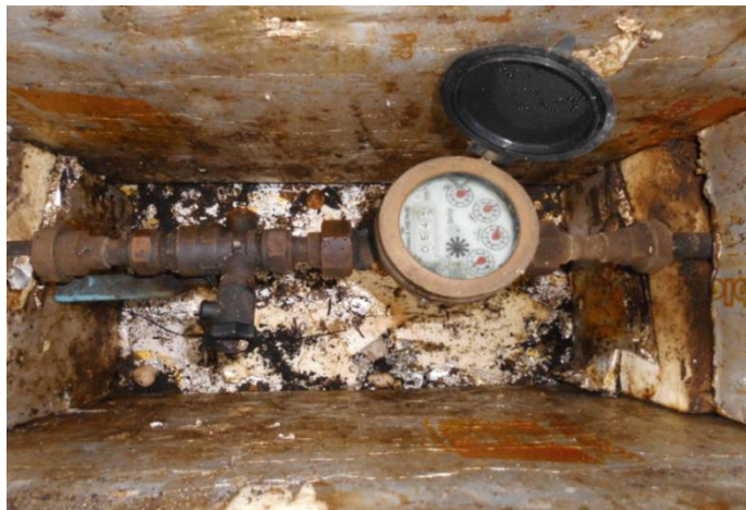
Watermeter in een geïsoleerde put.
