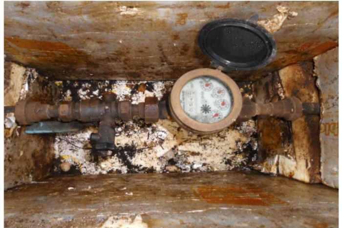
Watermeter in een geïsoleerde put.
